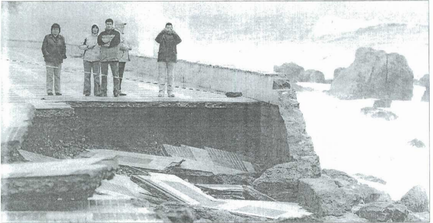
El Passeig Marítim de l'Escala va quedar molt malmès com a conseqüència de la força del mar.
