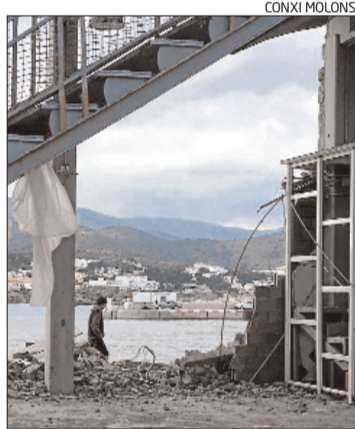
Destrosses a l'estructura.
