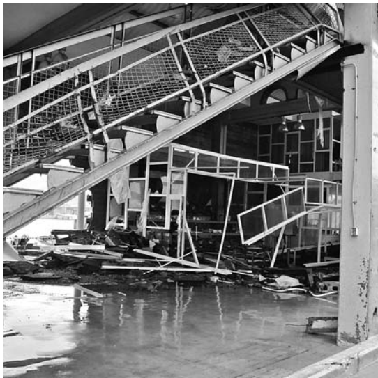
DESTROSSADA. Així va quedar la llotja de Llançà després del temporal
