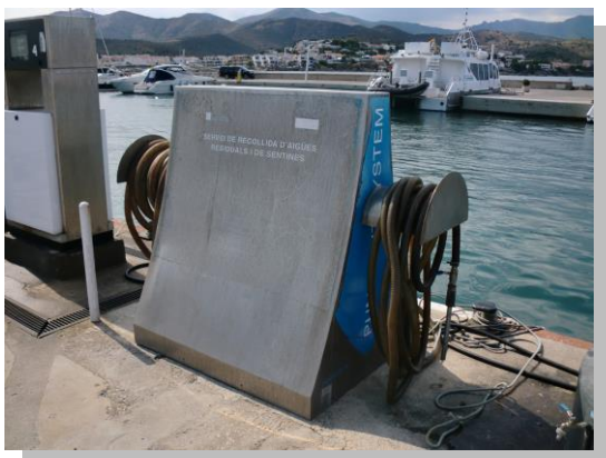
Punt d'aspiració al costat de la benzineria
